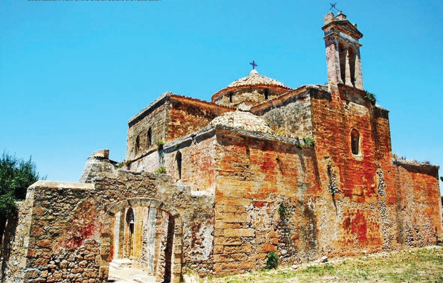
Νοτιοανατολική άποψη του ναού πριν από τις εργασίες αποκατάστασης Southeastern view of the church before the restoration
