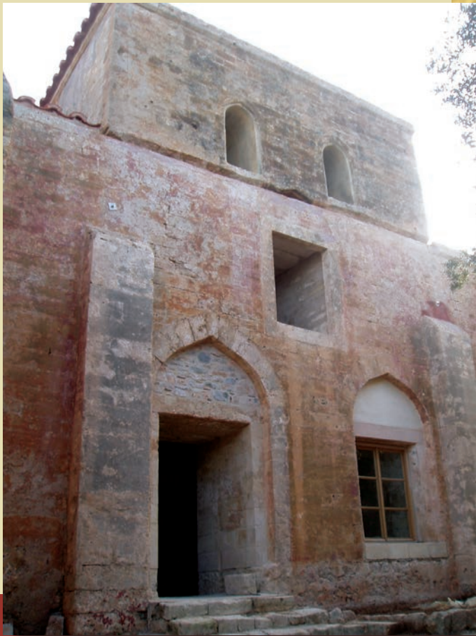
Η νότια όψη του μνημείου μετά τις εργασίες αποκατάστασης South view of the church after the restoration
